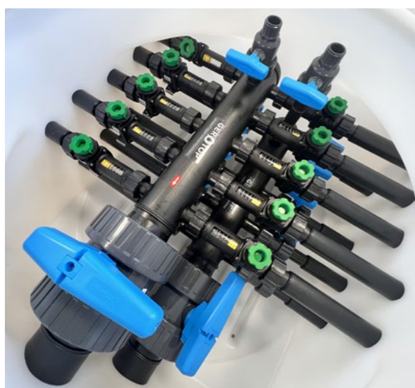
Svedení deseti vrtů v jímce a napojení na páteřní vedení do domu
